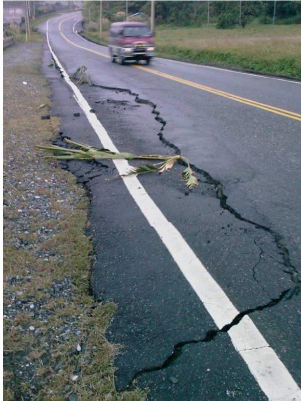
圖 6.44 台 11 線磯崎路段路面龜裂
