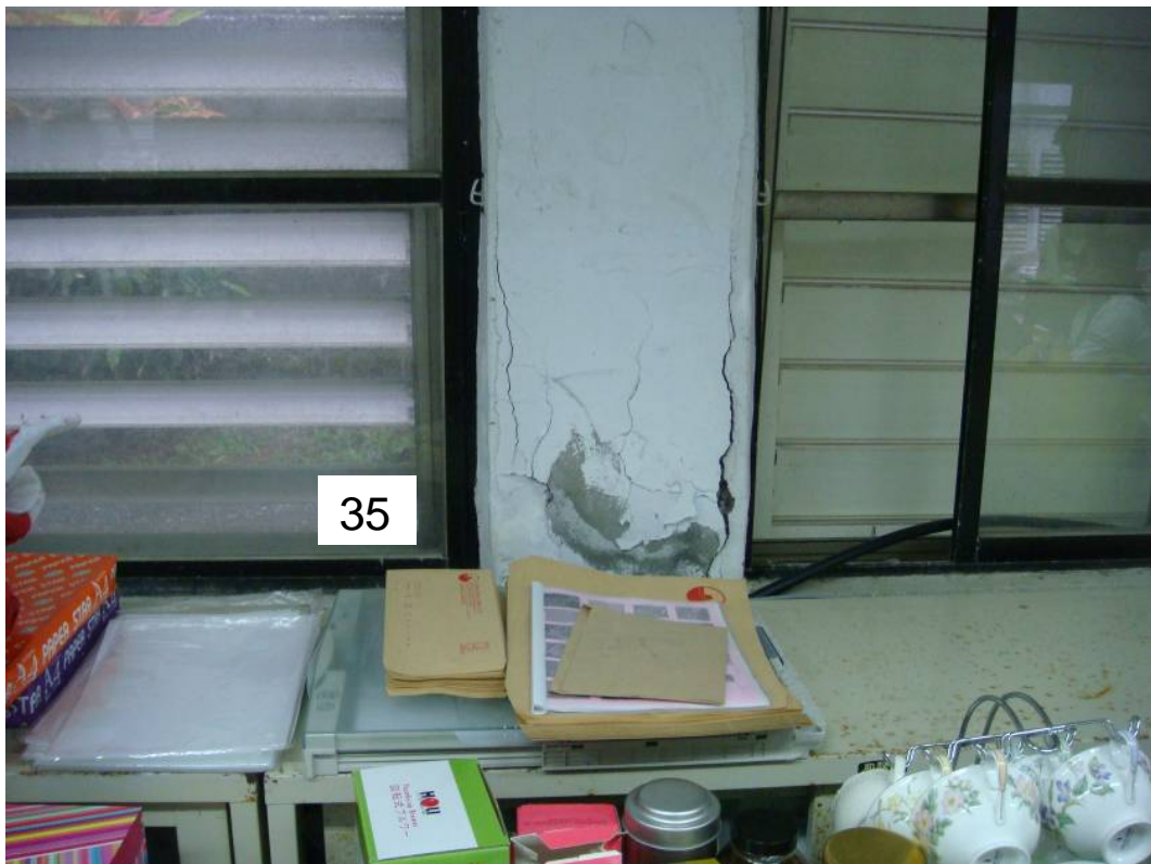
圖 5.100 台東三間國小教師辦公室窗台柱室內實際裂縫開裂情形
