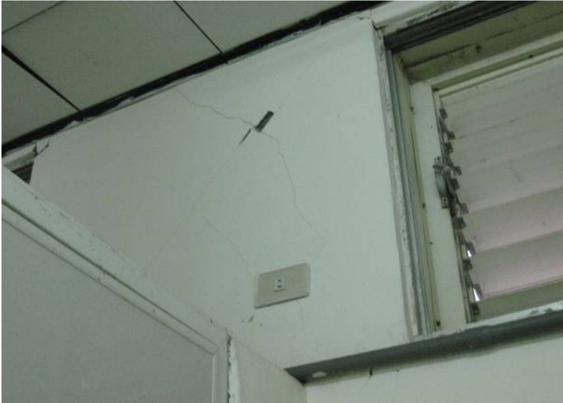
圖 5.68 新社國小北棟校舍高窗部份剪力破壞
