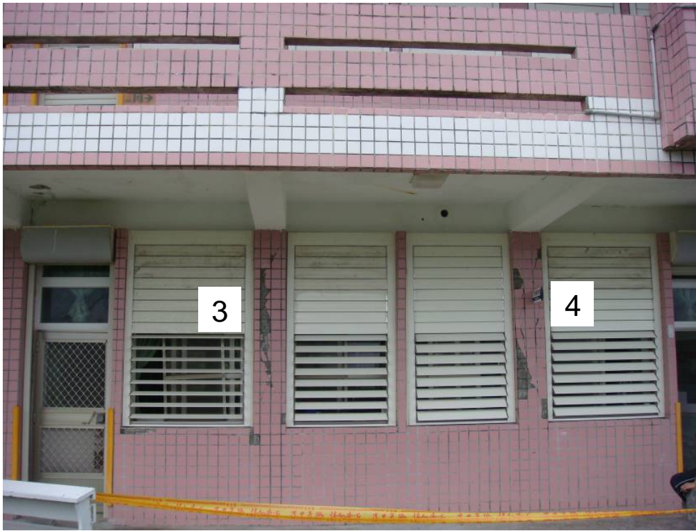
圖 5.75 台東三間國小教學行政大樓窗台柱 3、4 一樓室外實際裂縫開裂情形
