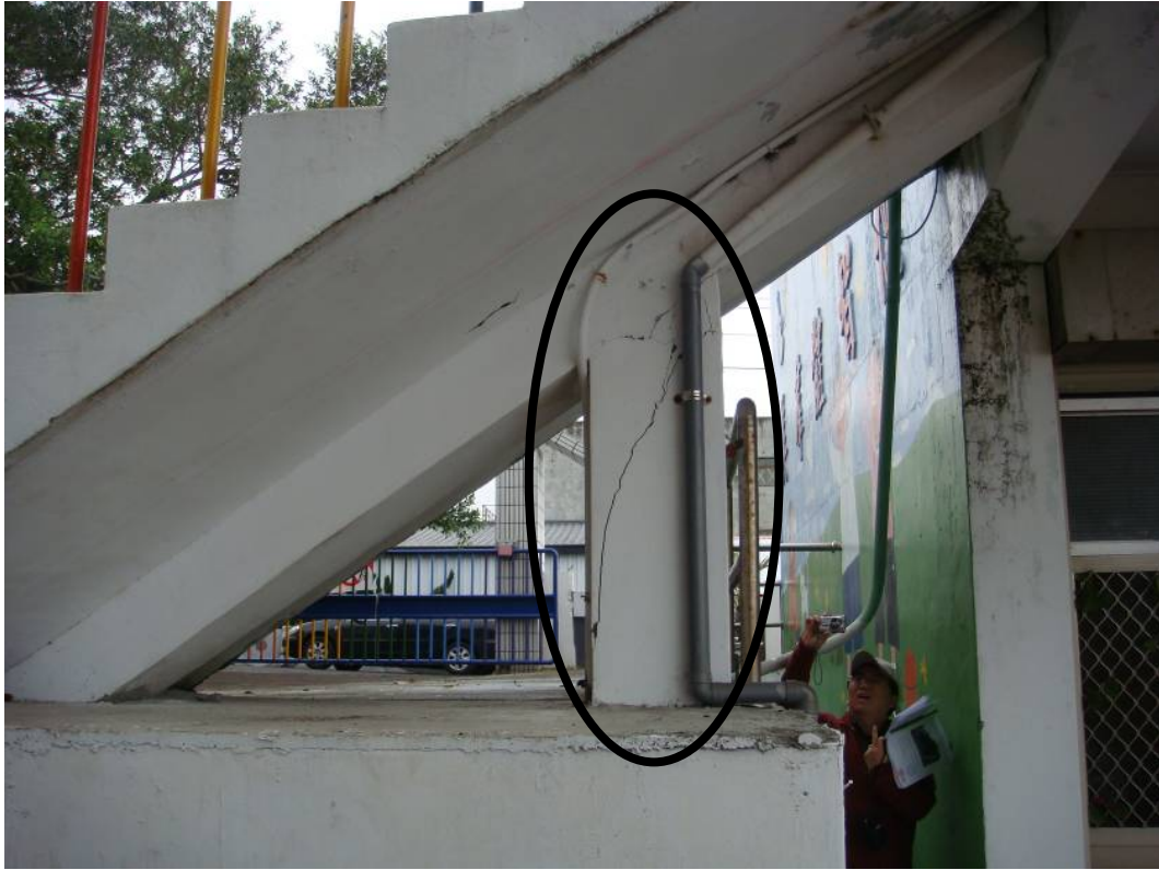
圖 5.118 信義國小忠信樓西側戶外樓梯下方支撐柱發生斜向裂縫
