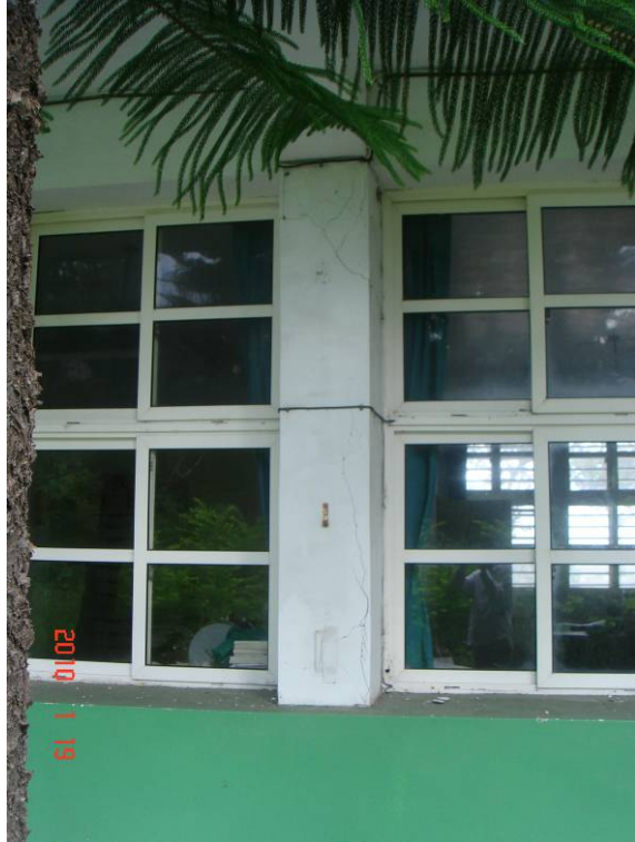
圖 5.10 磯崎分校教學教室 B4 柱明顯剪力開裂，裂縫寬度 1.0mm。
