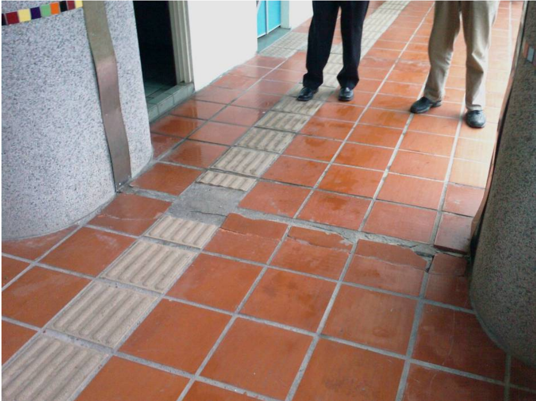
圖 5.41 化仁國中水漣分校教學行政大樓一樓地磚受損情形
