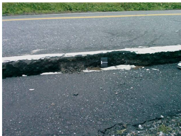
圖 6.43 台 11 線磯崎路段路面落差
