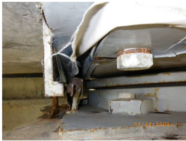
圖 6.24 P4-3 盤式支承角鐵彎折顯示上部結構經歷側向振動 (資料來源：偉蟲工程顧問有限公司)
