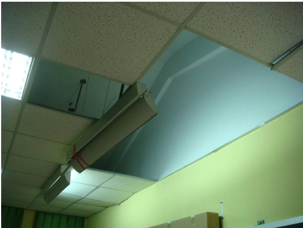
圖 5.114 信義國小教學大樓二樓教室內輕鋼架受震掉落。
