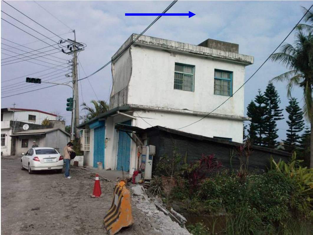
圖 5.123 磯崎村 47 號民宅基地向箭頭方向傾斜
