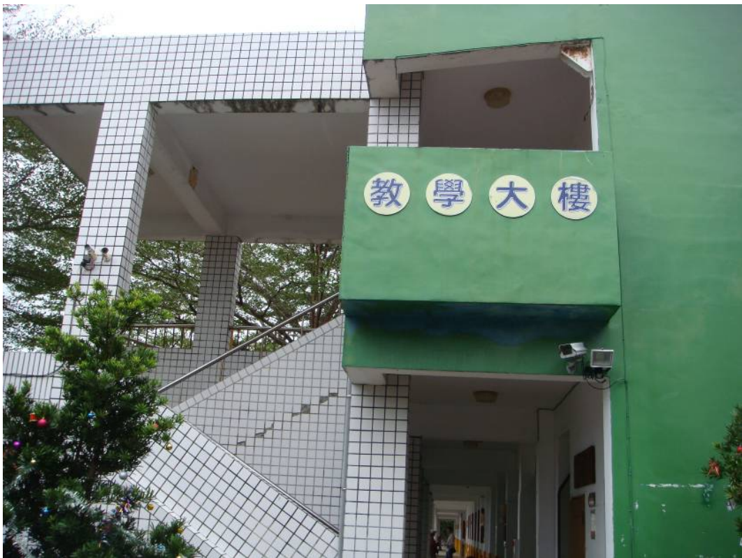
圖 5.112 信義國小教學大樓北側樓梯側牆在樓梯版下緣附近開裂。
