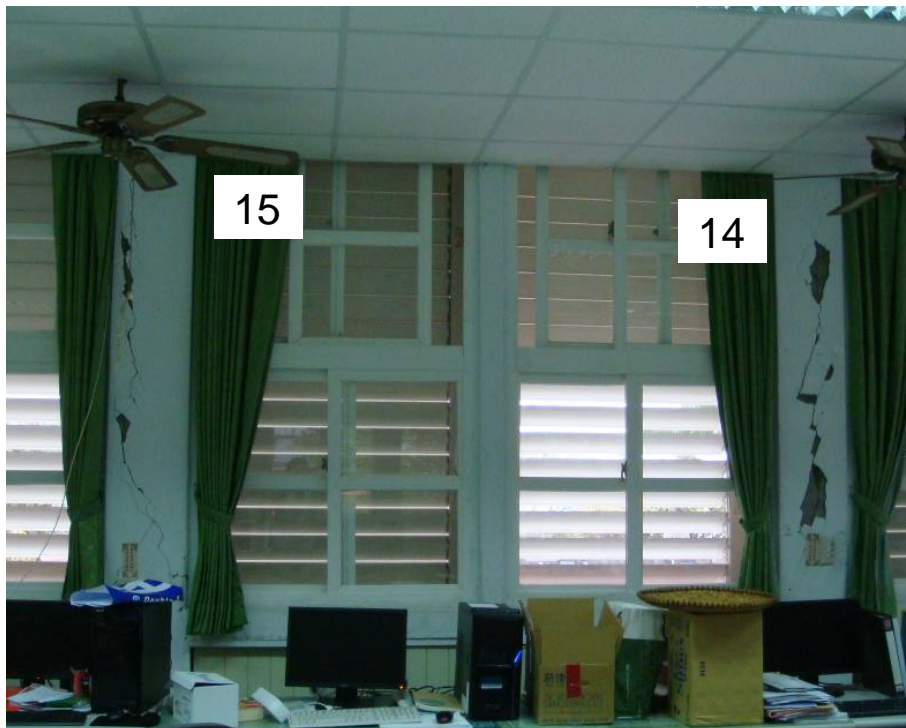
圖 5.82 台東三間國小教學行政大樓窗台柱 14、15 一樓室內實際裂縫開裂情形
