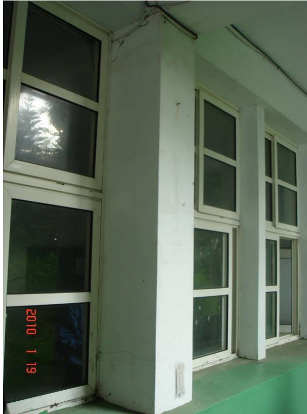
圖 5.8 磯崎分校教學教室 B2 柱頂及柱底撓剪開裂，裂縫寬度 0.2mm。
