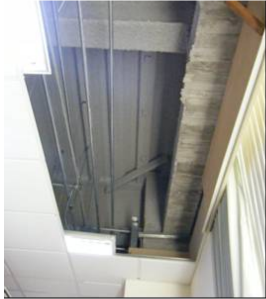
圖 7.11 天花板收邊處破壞細部：無收邊釘，距牆邊之第一條懸吊線大於耐震施工指針所要求 20 公分內
