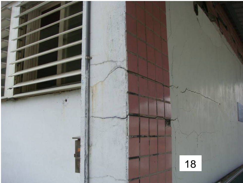
圖 5.83 台東三間國小教學行政大樓窗台柱 18 一樓室外實際裂縫開裂情形
