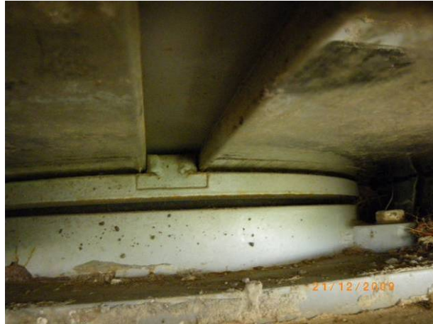
圖 6.29 P7-3 支承正常狀況(滑槽與樺密合、滑槽深度 1cm) (資料來源：偉蟲工程顧問有限公司)
