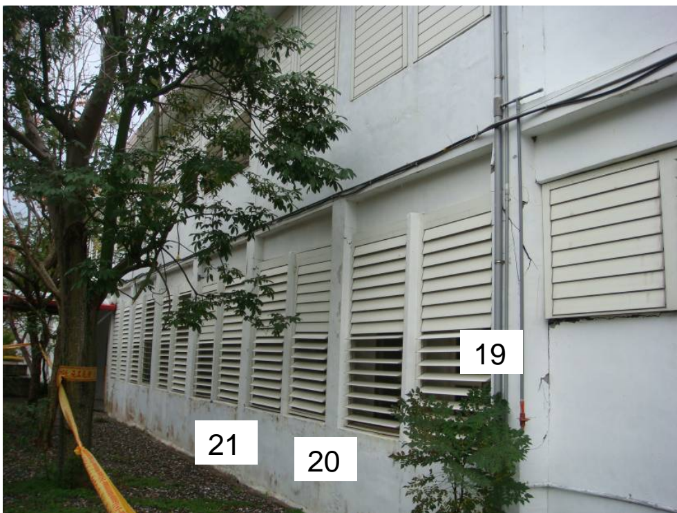
圖 5.84 台東三間國小教學行政大樓窗台柱 19、20、21 一樓室外實際裂縫開裂情形
