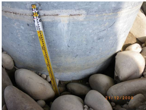
圖 6.31 P4 左側橋墩面未發現明顯開裂情形 (資料來源：偉蟲工程顧問有限公司)
