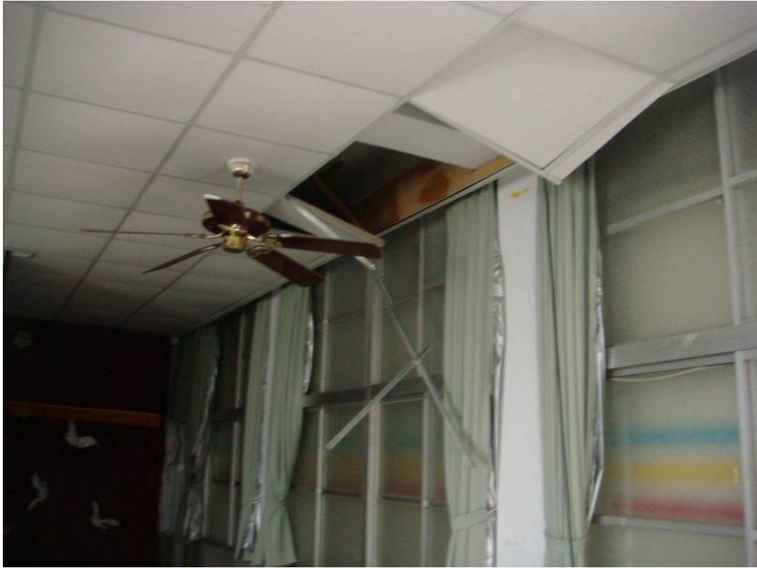
圖 5.120 信義國小忠信樓教室內局部輕鋼架掉落
