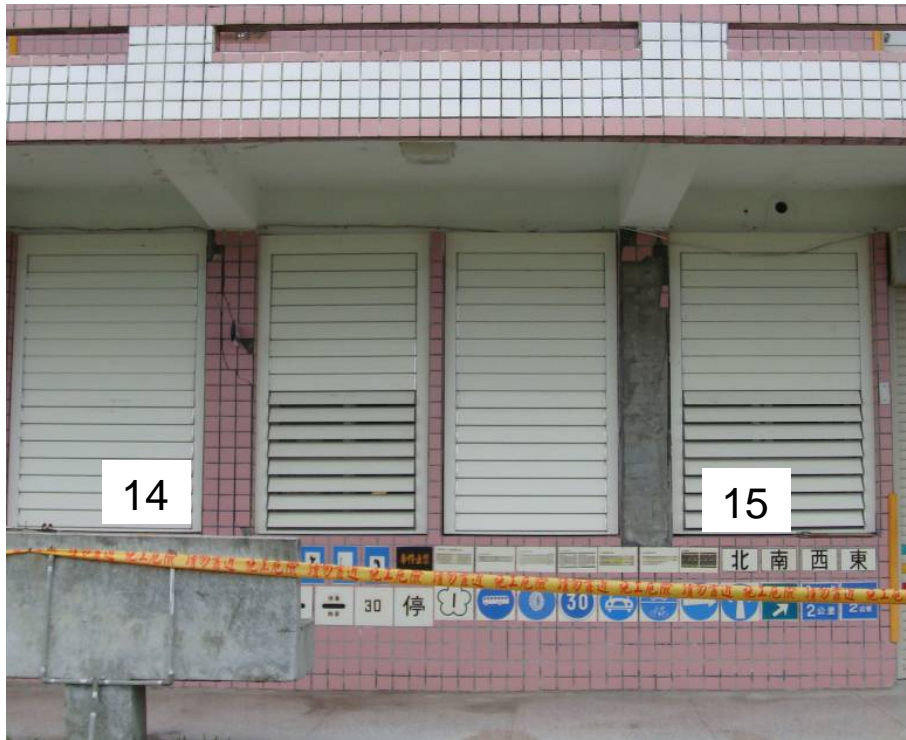
圖 5.81 台東三間國小教學行政大樓窗台柱 14、15 一樓室外實際裂縫開裂情形
