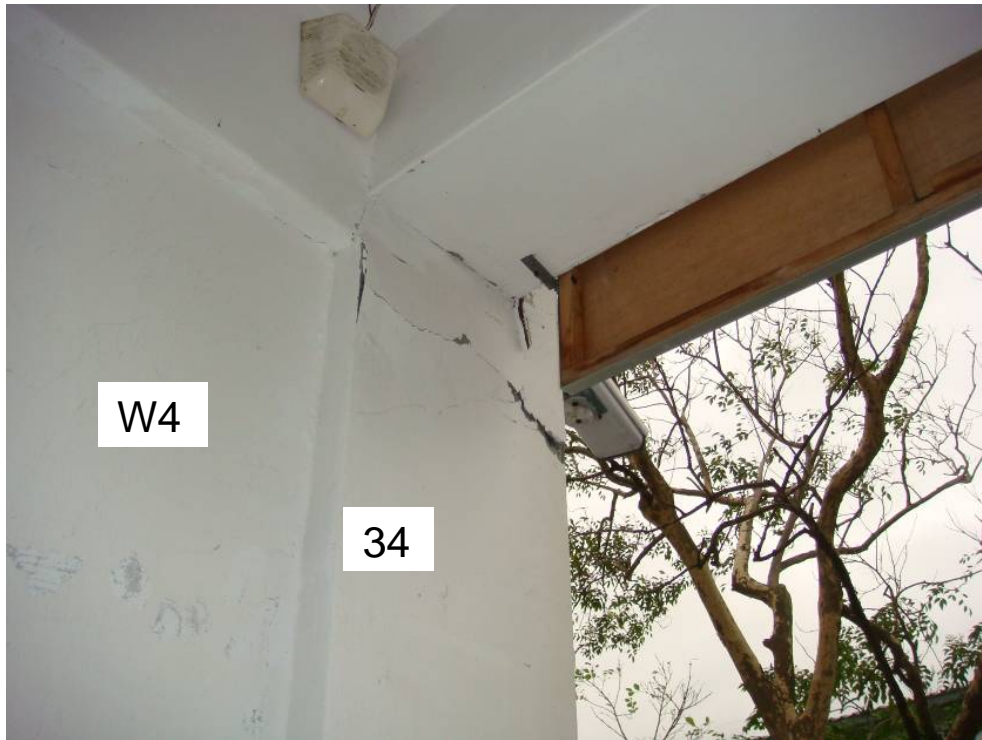
圖 5.89 台東三間國小教學行政大樓窗台柱 34 一樓實際裂縫開裂情形
