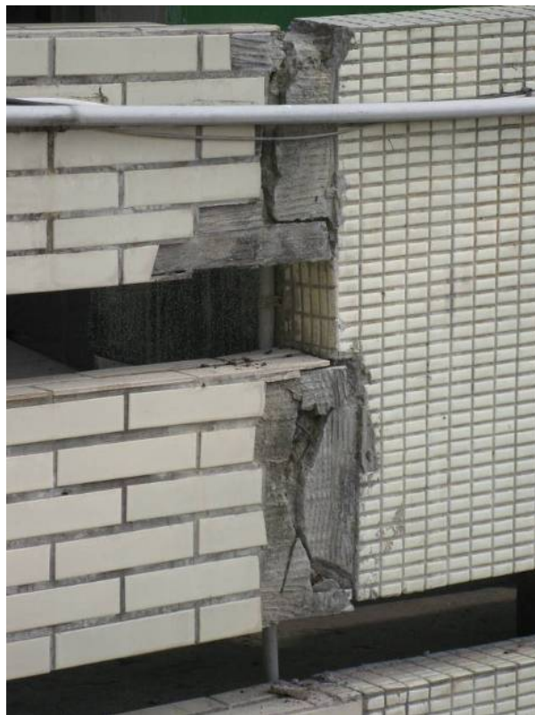
圖 5.62 稻香國小北側教室相鄰建築物間伸縮縫碰撞，以致貼附材破裂掉落
