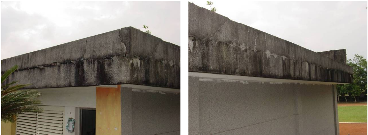
圖 5.22 太巴塢國小活動中心屋頂漏水造成外牆龜裂
