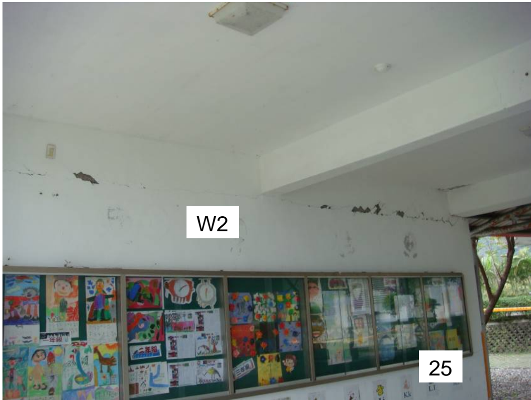
圖 5.95 台東三間國小教學行政大樓牆 W2 一樓面外變形與裂縫開裂情形
