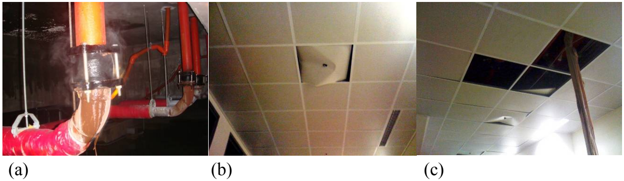
圖 7.31 (a)隔震層蒸汽管伸縮拉桿受損(b)受消防管線拉扯後天花嵌板變形 (c)空中通道撒水頭受損後之消防管線置換作業 (本圖照片均由慈濟醫院工務單位提供)
