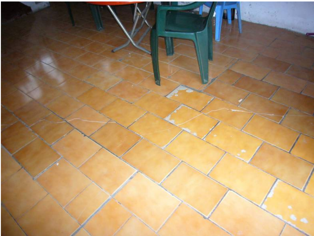
圖 5.124 磯崎村 47 號民宅室內地板龜裂
