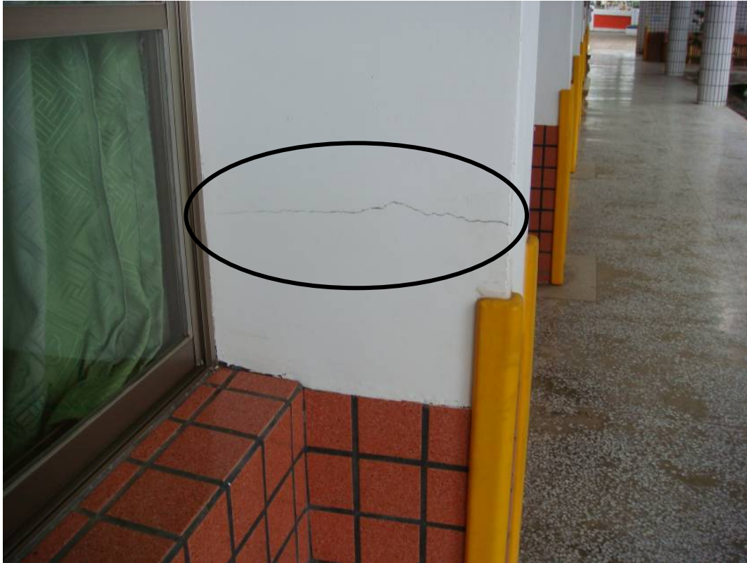
圖 5.109 信義國小教學大樓窗台柱下端受震開裂情形
