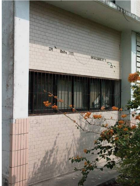
圖 5.50 豐裡國小教學大樓樓梯間梁出現裂縫，建築物背面貼覆材受損掉落
