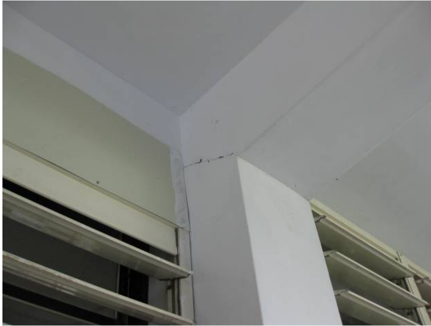
圖 5.47 豐裡國小教學大樓梁柱接頭處出現裂縫
