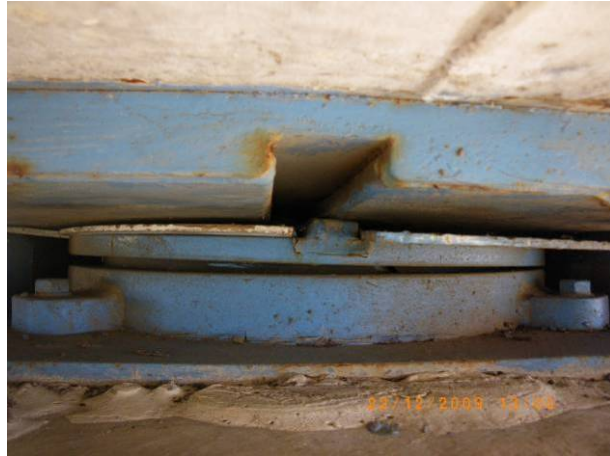
圖 6.20 P4-1 盤式支承上盤與導桿脫離並向右側側移 (資料來源：偉蟲工程顧問有限公司)
