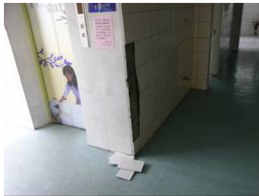
圖 7.25 圖書室入口處電梯間牆面磁磚掉落
