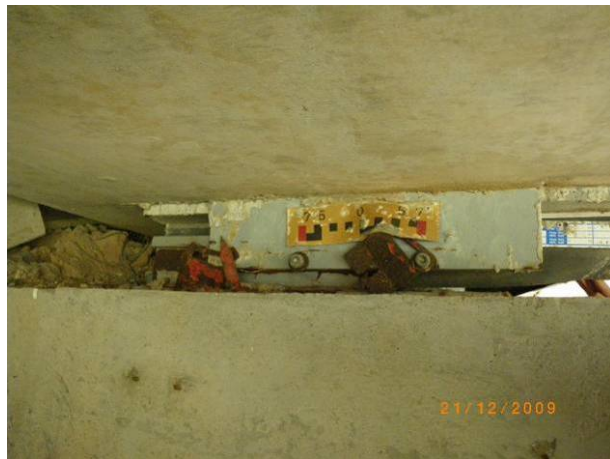
圖 6.30 P7-4 支承橋軸方向變位大於 7cm (資料來源：偉蟲工程顧問有限公司)
