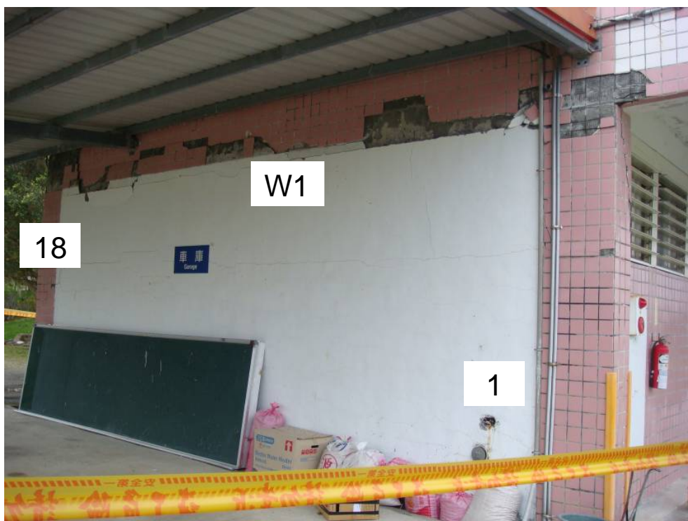
圖 5.94 台東三間國小教學行政大樓牆 W1 一樓面外變形與裂縫開裂情形
