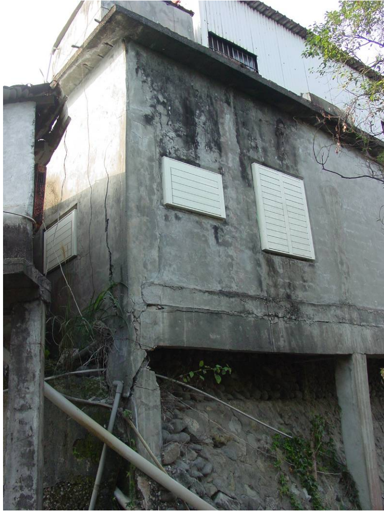
圖 5.127 磯崎村 52 號民宅背面基礎及基腳破壞情形
