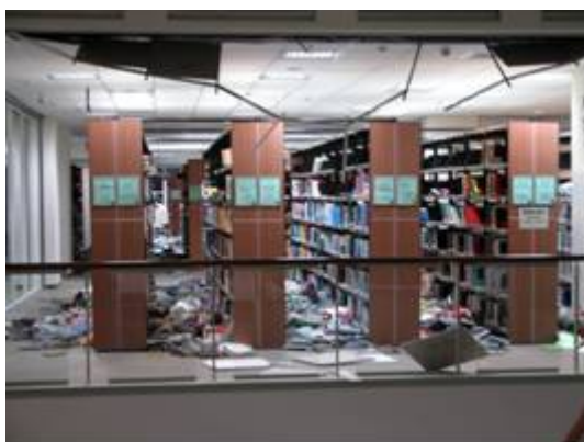
圖 7.4 圖書掉落及天花板破壞(東華大學圖書館提供)
