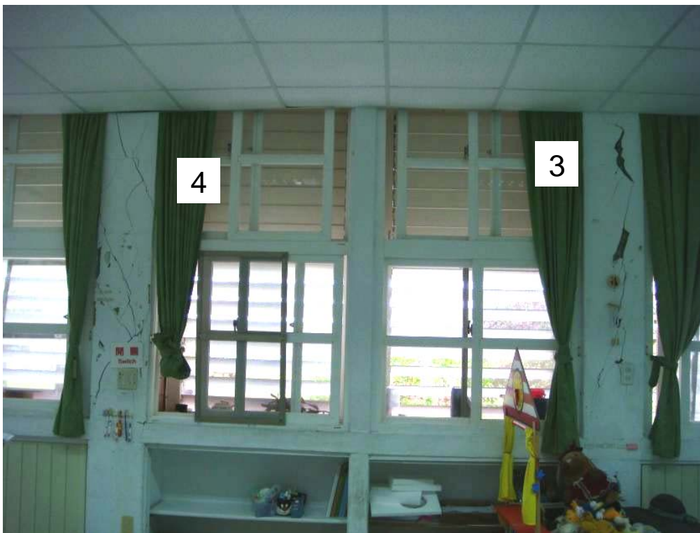
圖 5.76 台東三間國小教學行政大樓窗台柱 3、4 一樓室內實際裂縫開裂情形
