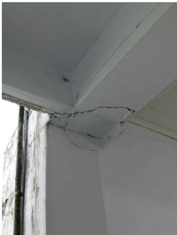
圖 5.49 豐裡國小教學大樓梁端因伸縮縫碰撞而開裂
