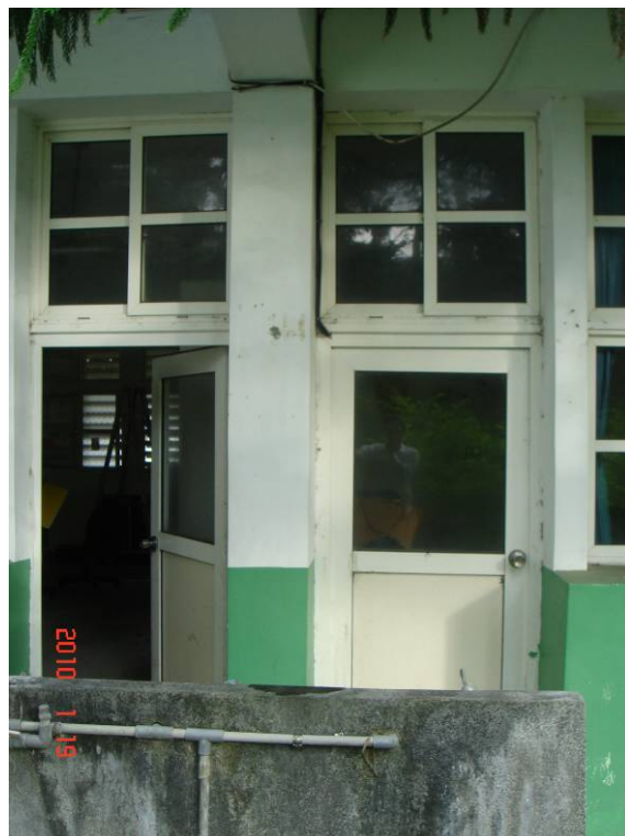
圖 5.9 磯崎分校教學教室 B3 柱底撓曲開裂，裂縫寬度 1.0mm。
