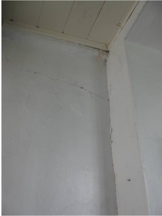
圖 5.48 豐裡國小教學大樓磚翼牆輕微開裂
