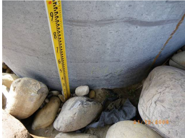
圖 6.32 P4 右側橋墩面未發現明顯開裂情形 (資料來源：偉蟲工程顧問有限公司)
