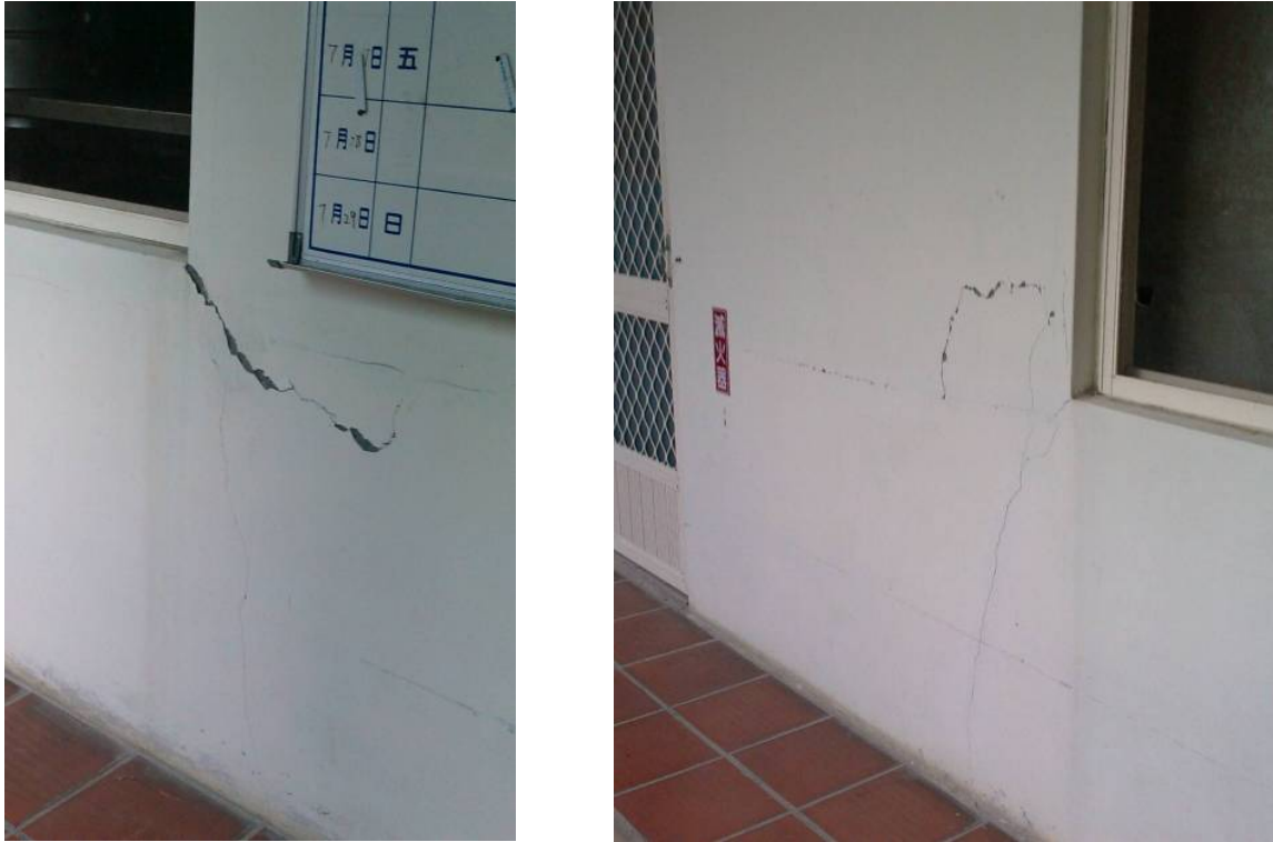
圖 5.43 化仁國中水漣分校教學行政大樓一樓磚牆受損情形
