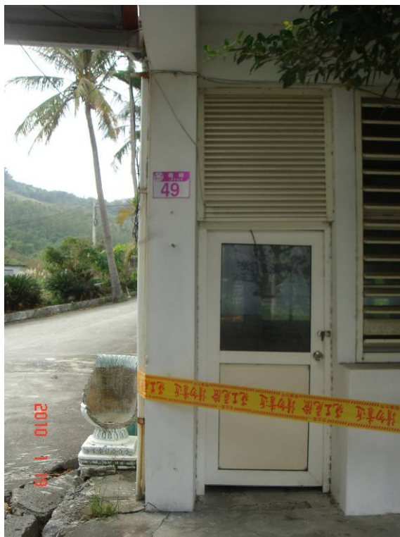
圖 5.20 磯崎分校教學教室 D7 柱無明顯破壞。
