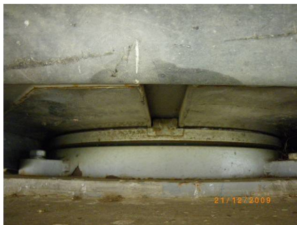
圖 6.28 P7-2 支承正常狀況(滑槽與樺密合、滑槽深度 1cm) (資料來源：偉蟲工程顧問有限公司)
