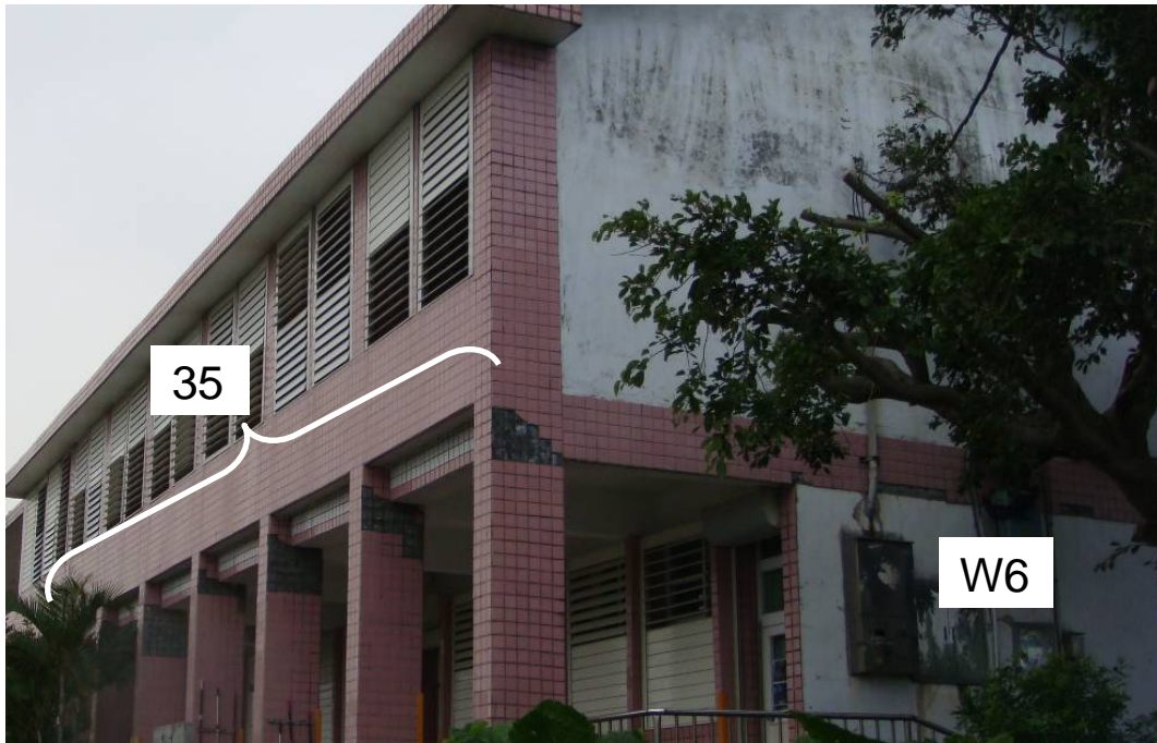
圖 5.99 台東三間國小教學行政大樓牆 W6 一樓裂縫開裂與一樓柱 35 上端磁磚掉落情形
