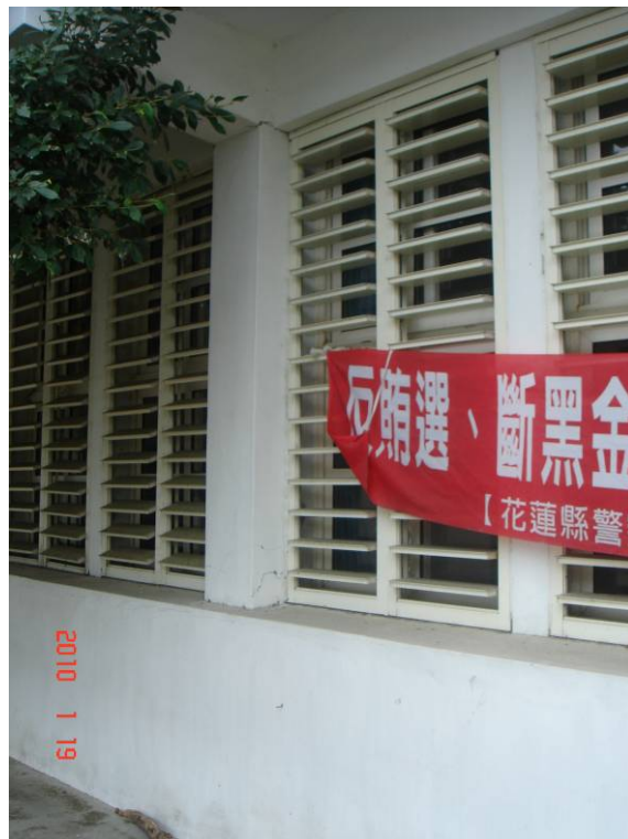
圖 5.18 磯崎分校教學教室 D5 柱底部剪力破壞，裂縫寬度 0.65mm。
