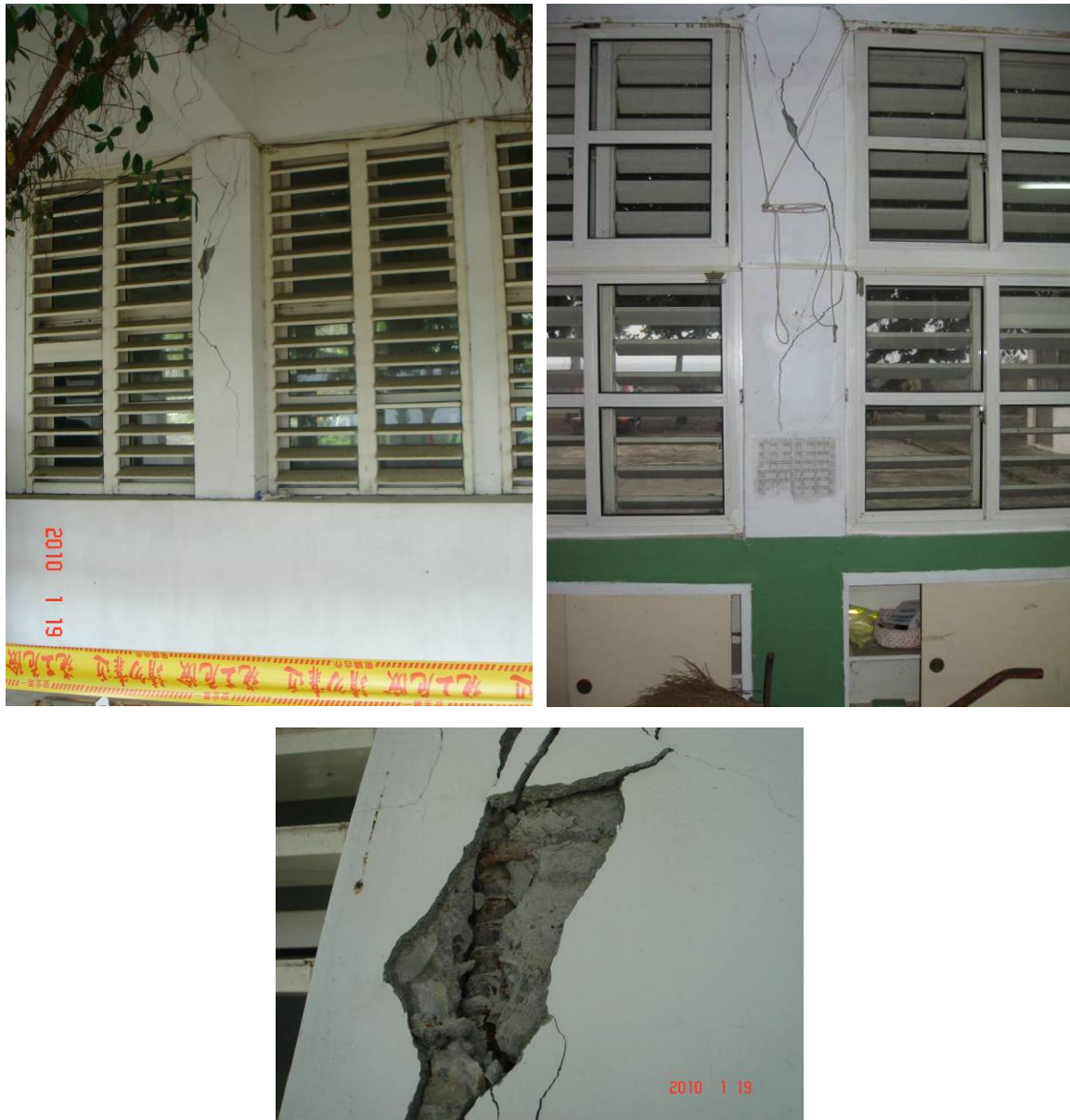
圖 5.19 磯崎分校教學教室 D6 柱明顯剪力開裂，裂縫寬度達 6mm，左上為室外拍攝，右上為室內拍攝，下為混凝土塊剝落後，主筋外露。
