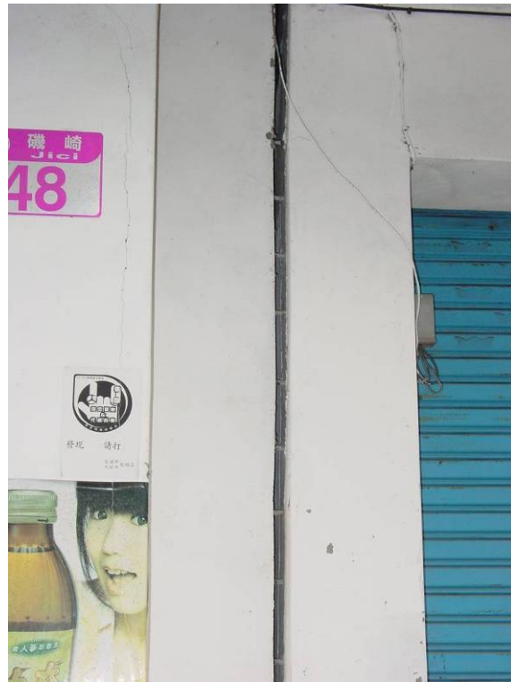
圖 5.125 磯崎村 47 號與 48 號民宅鄰柱錨定脫離
