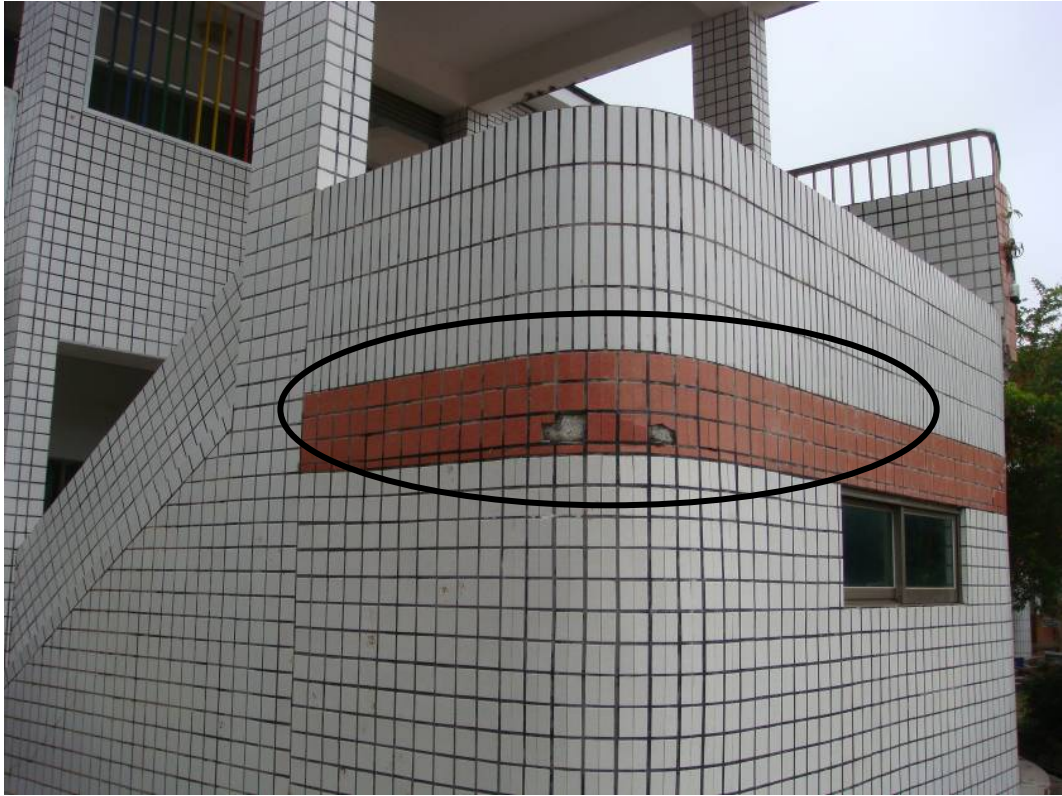
圖 5.113 信義國小教學大樓南側樓梯平台外側磁磚輕微剝落
