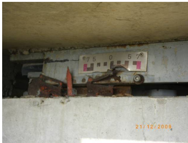
圖 6.27 P4-4 支承橋軸方向變位大於 7cm (資料來源：偉蟲工程顧問有限公司)
