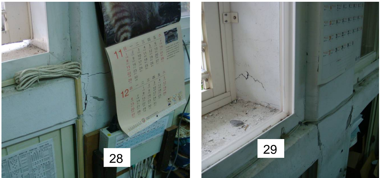
圖 5.86 台東三間國小教學行政大樓窗台柱 28、29 一樓室內實際裂縫開裂情形
