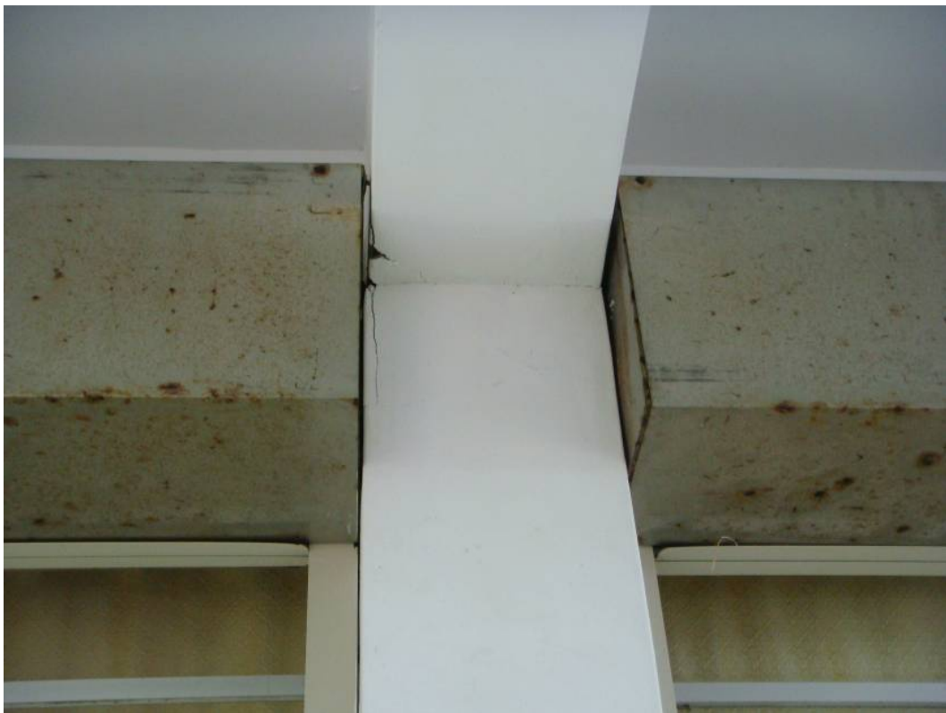
圖 5.119 信義國小忠信樓窗台柱上方發生些微裂縫
