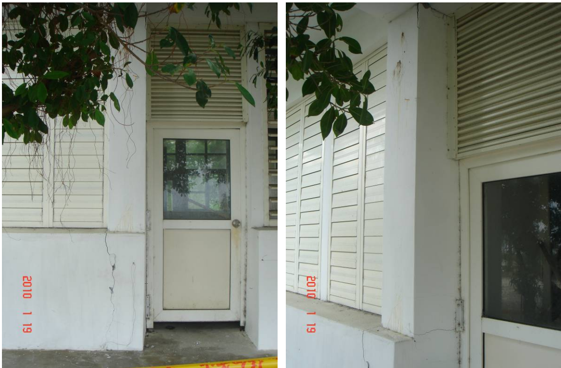
圖 5.16 磯崎分校教學教室 D3 柱側邊窗台開裂，右為柱底撓曲裂縫 1mm。
