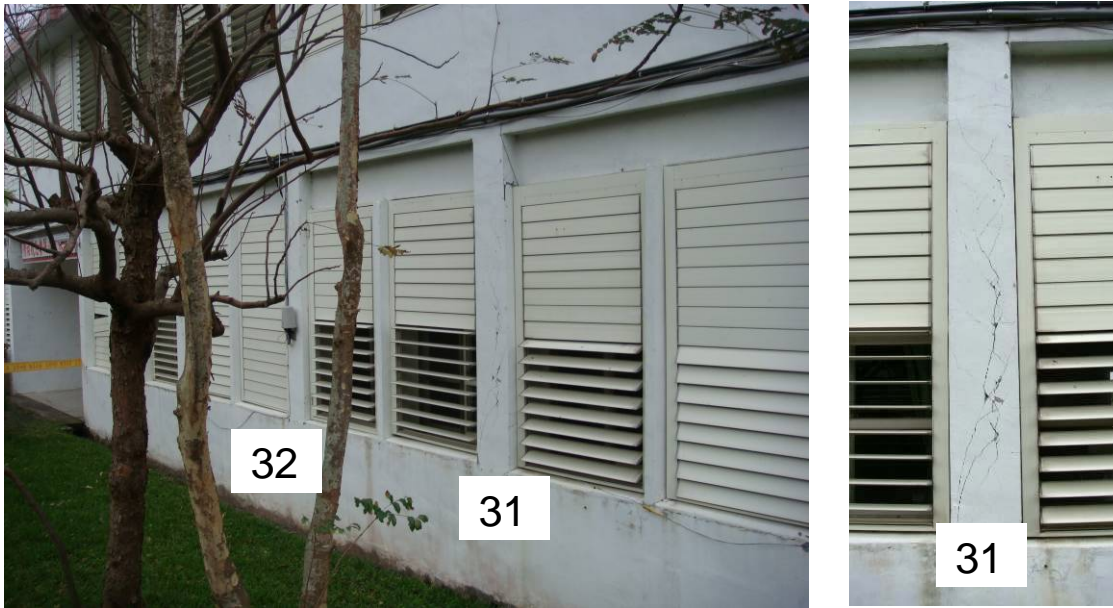
圖 5.87 台東三間國小教學行政大樓窗台柱 31、32 一樓室外實際裂縫開裂情形
