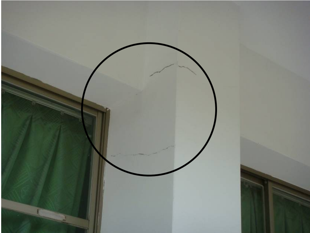
圖 5.107 信義國小教學大樓窗台柱上端受震開裂情形
