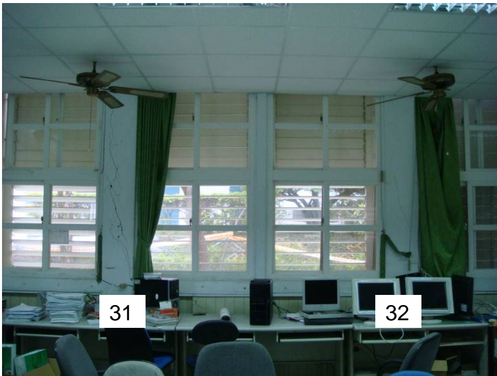
圖 5.88 台東三間國小教學行政大樓窗台柱 31、32 一樓室內實際裂縫開裂情形
