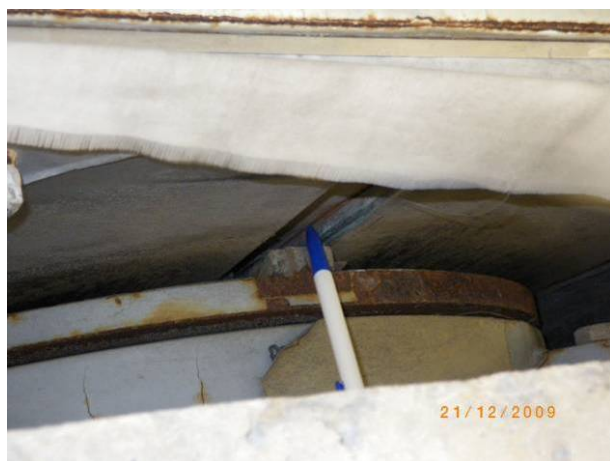
圖 6.25 P4-3 盤式支承墊翹起 (資料來源：偉蟲工程顧問有限公司)
