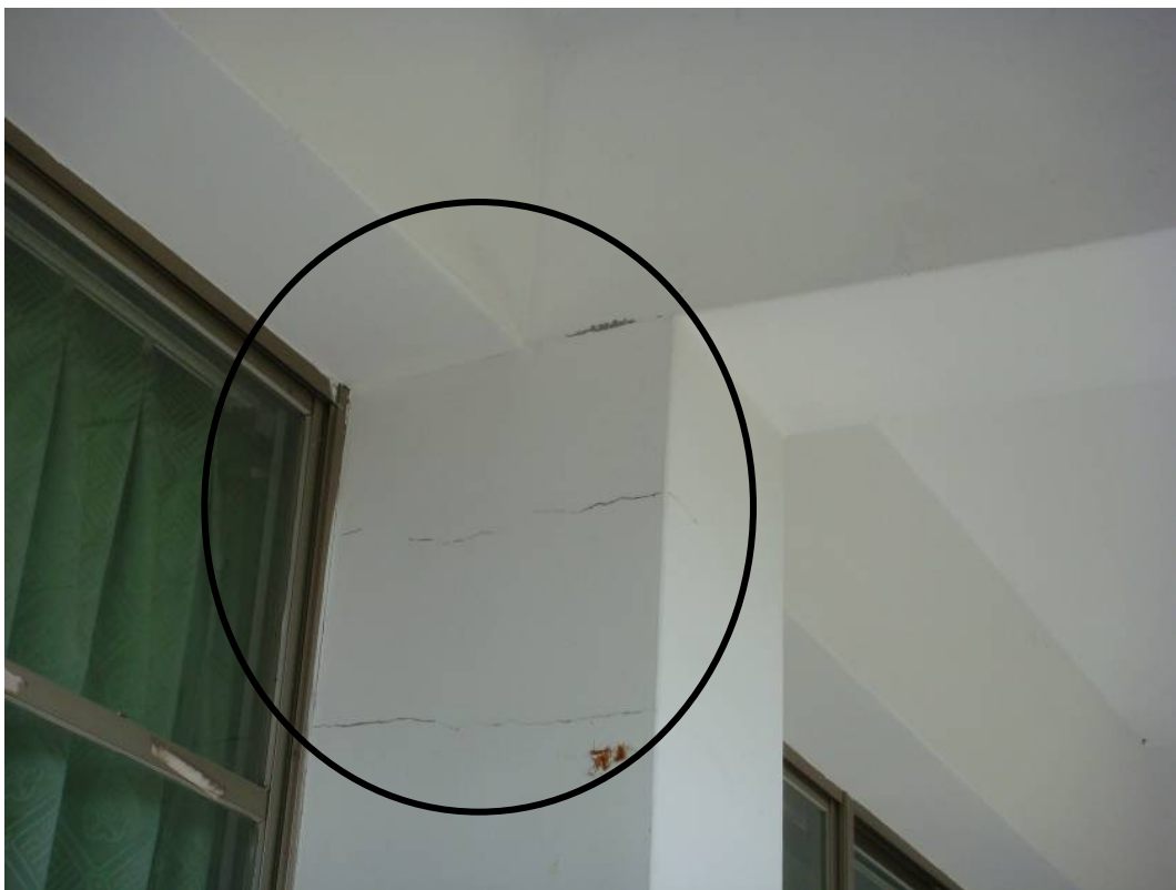
圖 5.108 信義國小教學大樓窗台柱上端受震開裂情形
