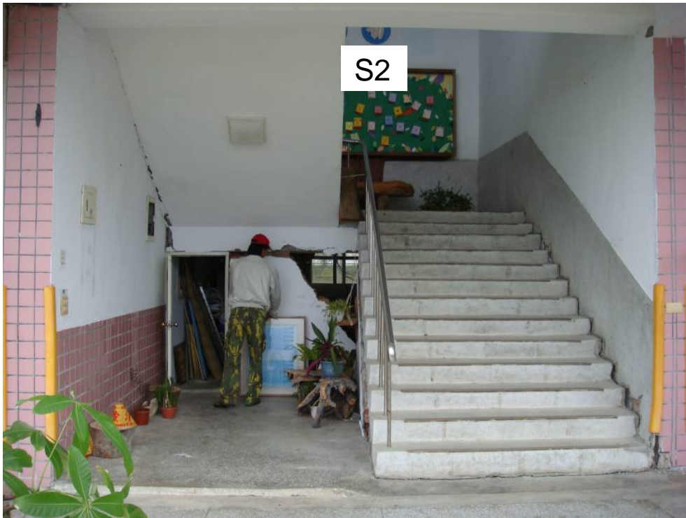
圖 5.93 台東三間國小教學行政大樓樓梯 S2 一樓平台下方儲藏室外牆嚴重破壞與樓梯踏階錯位情形
