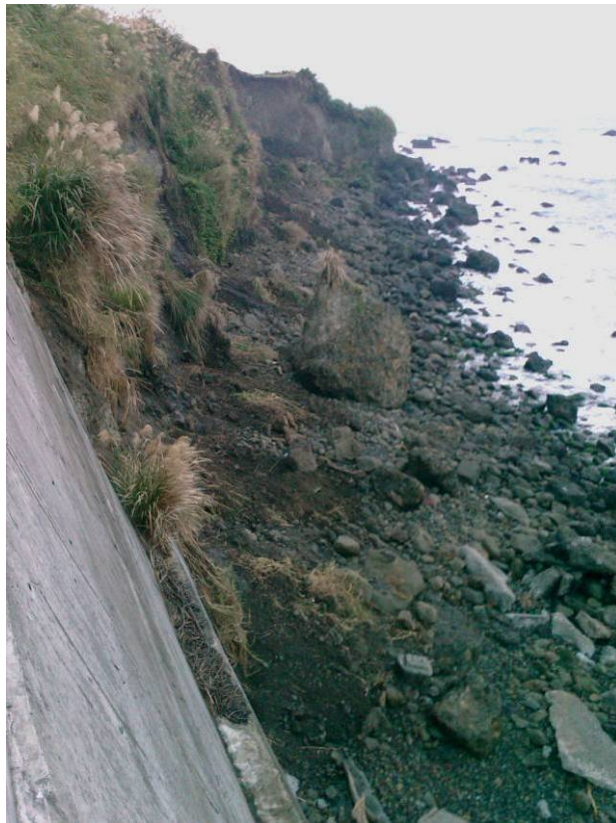
圖 6.45 台 11 線磯崎路段落石
