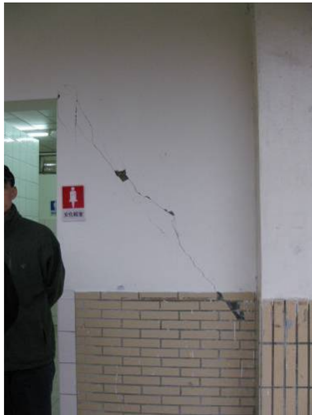
圖 5.67 新社國小北棟校舍一樓廁所門旁磚牆
