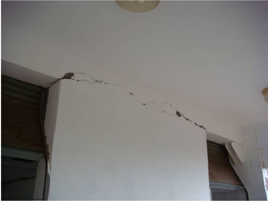
圖 5.111 信義國小教學大樓北側二樓廁所走廊側牆與梁接面處開裂
