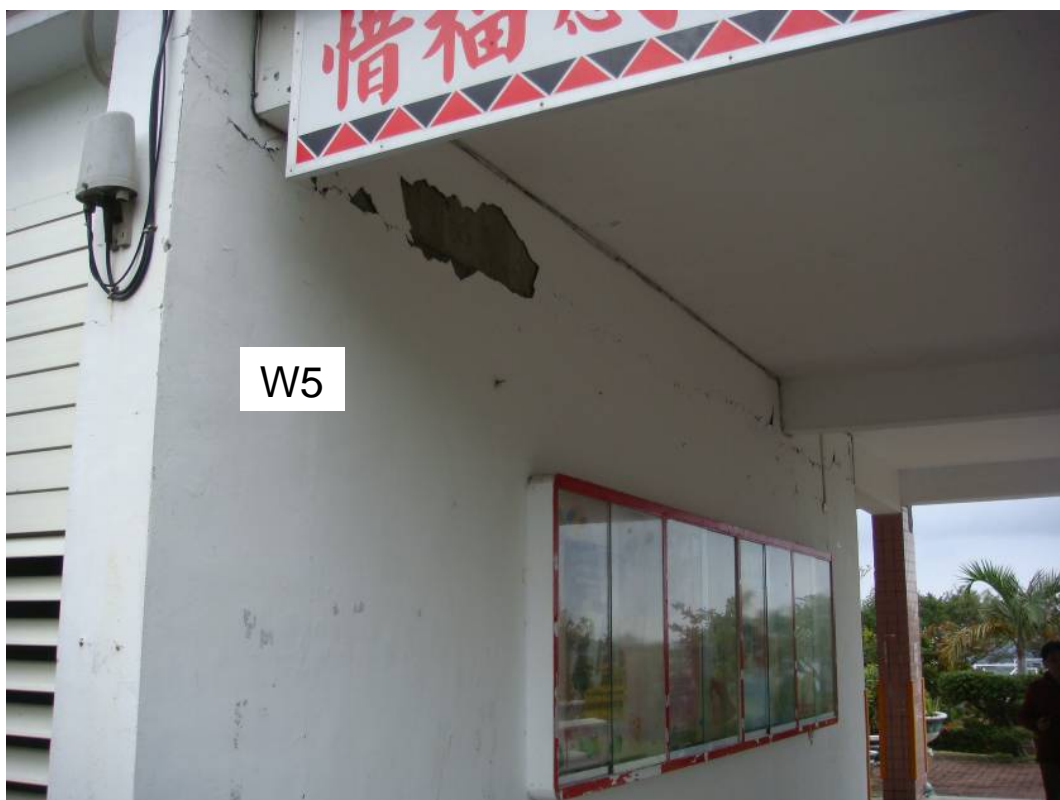
圖 5.98 台東三間國小教學行政大樓牆 W5 一樓面外變形與裂縫開裂情形
