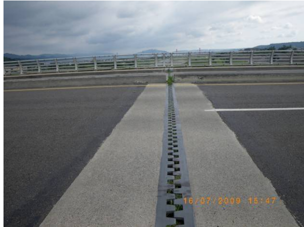
圖 6.14 P4 伸縮縫情形(尖與尖尚有重疊約 1cm，98 年 7 月 16 日拍攝) (資料來源：偉蟲工程顧問有限公司)
