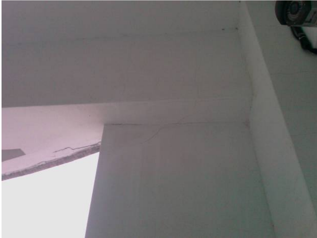
圖 5.36 水璉國小圖書館下方梁之裂縫
