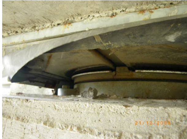
圖 6.26 P4-4 盤式支承上盤翹起、角鐵彎折顯示上部結構經歷側向振動 (資料來源：偉蟲工程顧問有限公司)
