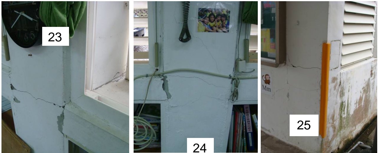
圖 5.85 台東三間國小教學行政大樓窗台柱 23、24、25 一樓實際裂縫開裂情形
