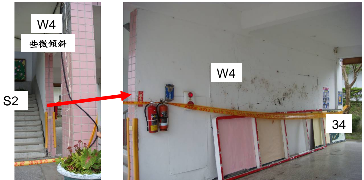
圖 5.97 台東三間國小教學行政大樓牆 W4 一樓面外變形與裂縫開裂情形
