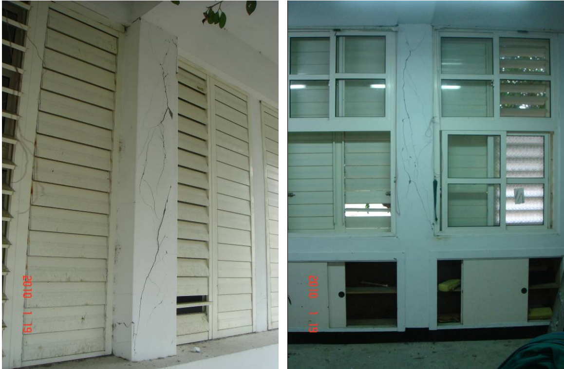
圖 5.15 磯崎分校教學教室 D2 柱明顯剪力破壞，裂縫寬度達 3mm，並有微小混凝土塊剝落，左為室外拍攝，右為室內拍攝。
