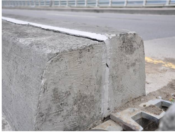
圖 6.17 P4 橋墩橋面橫向伸縮縫分離
